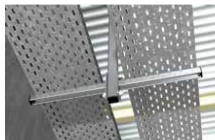
Supporti sospesi per cavi elettrici
